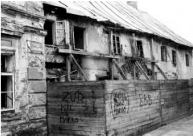
Karlovac, »Zvijezda« — zaštićena drvena kuća nakon raketiranja u Križanićevoj ulici. Kuća tesara Raucha.
