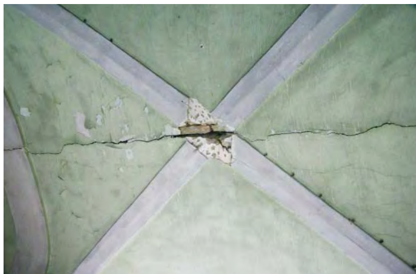
Oštećenje svoda u srednjem, zapadnom polju veže, 2011.
