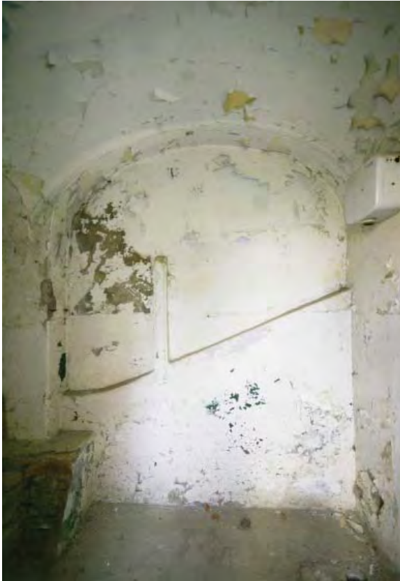
Tragovi stubišne ograde - istočni zid prostorije 41, 2011.
