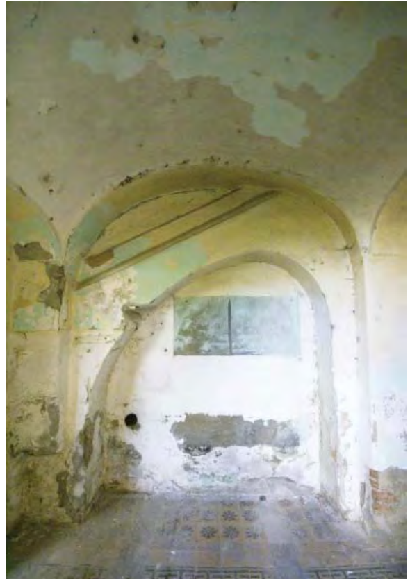
Tragovi stubišne ograde - istočni zid prostorije 40, 2011.
