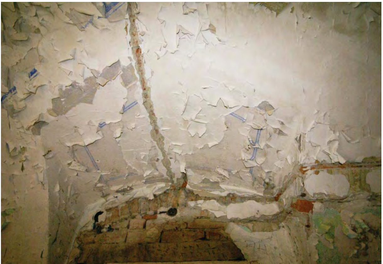
Tragovi plavog oslika na svodu prostorije 28 u prizemlju južnog krila, 2011.
