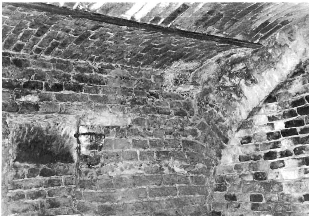
Prelog, zgrada župnog dvora — istočna prostorija u podrumu; na strukturi svoda vidi se otučena opeka pete negdašnjeg bačvastog svoda i nova konstrukcija pruske kape na traverzama
