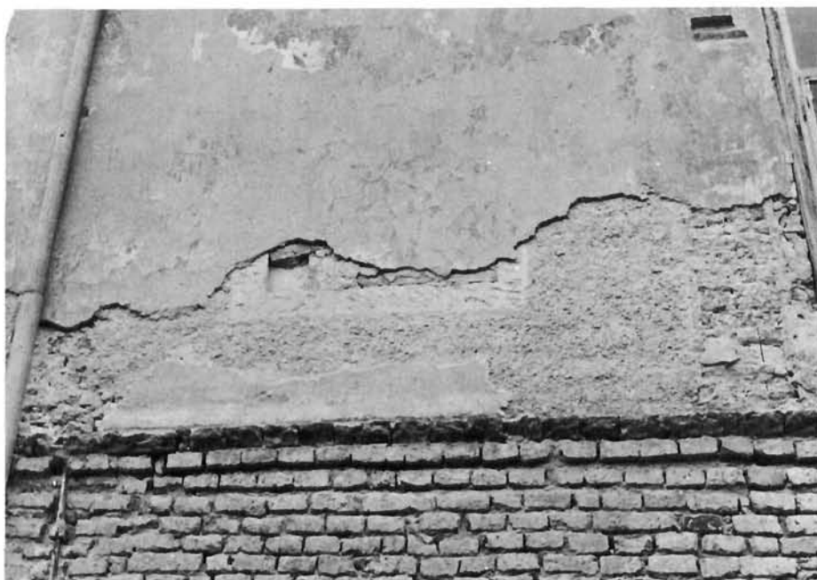
Prelog, zgrada župnog dvora — detalj na južnom rubu istočnog pročelja u zoni prvog kata; na sondi se vidi donji dio slijepog prozora, tragovi otučene lezene uz novootvoreni prozor i lijevo od slijepog prozora, grubo naštrcana žbuka i nakucani glatki okvir prozora
