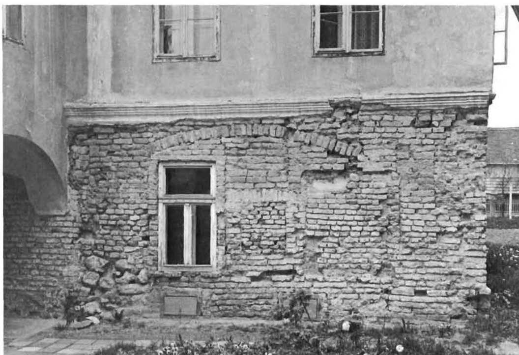
Prelog, zgrada župnog dvora — južna strana zapadnog pročelja, detalj prizemne zone; vide se tragovi sječenih pojasnica u sredini i na južnom rubu, trag luka u zidnoj strukturi i dilatacija pod trijemom, izmijenjeni prozor i trag slijepog prozora nakon skidanja žbuke
