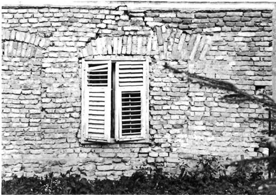
Prelog, zgrada župnog dvora — detalj zapadne strane sjevernog pročelja u zoni prizemlja; vidi se da je pomaknut otvor i ozbiljno narušen osnovni konstruktivni sustav nadvoja; stanje nakon skidanja žbuke
